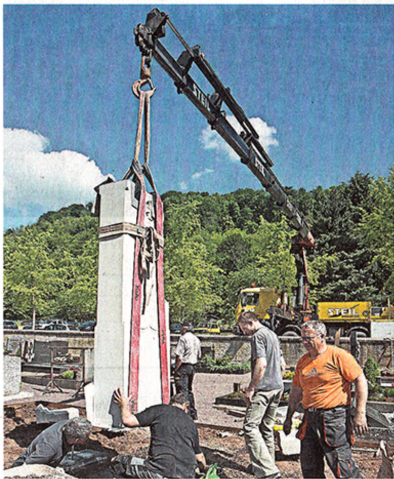
Ein Kran hievt den 2,6 Tonnen schweren Sandsteinblock auf dessen Fundament. FOTOS: HARTMANN JENAL (2), GEMEINDE WADGASSEN
